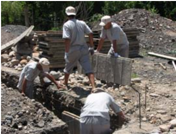
Строительство малогабаритного энергоэффективного здания ФАП в селе Курманжан-Датка Алайского района Ошской области
