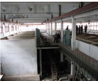
В одном из помещений водоканала г. Майлуу-Суу Жалалабатской области
