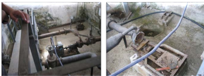
Фото 1-2. Текущее состояние насосных установок водозабора «Западный»
